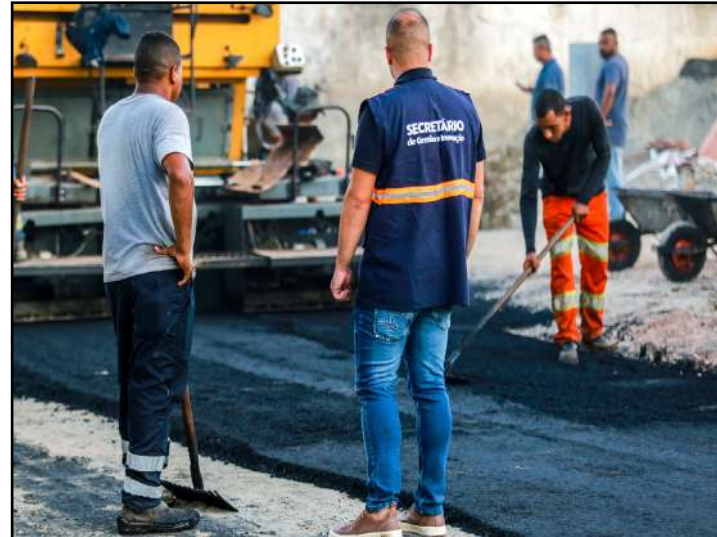
O secretário Matheus Carneiro vistoriou as obras de pavimentação asfáltica da Rua Breno de Souza
