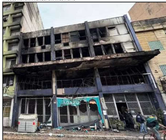
Local onde ocorreu o incêndio que matou 10 pessoas
