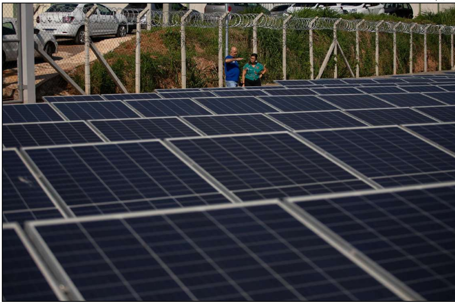
A usina foi construída pela prefeitura em parceria com a Light, no Roma
