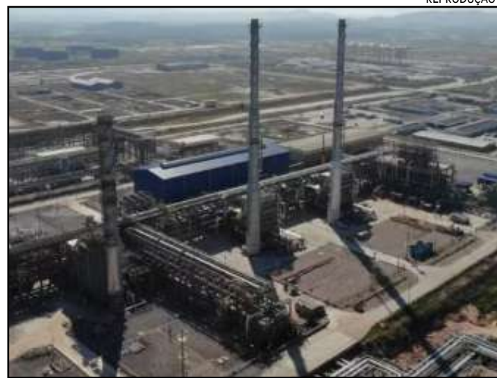
Obras da refinaria devem gerar cerca de 10 mil empregos diretos e indiretos
