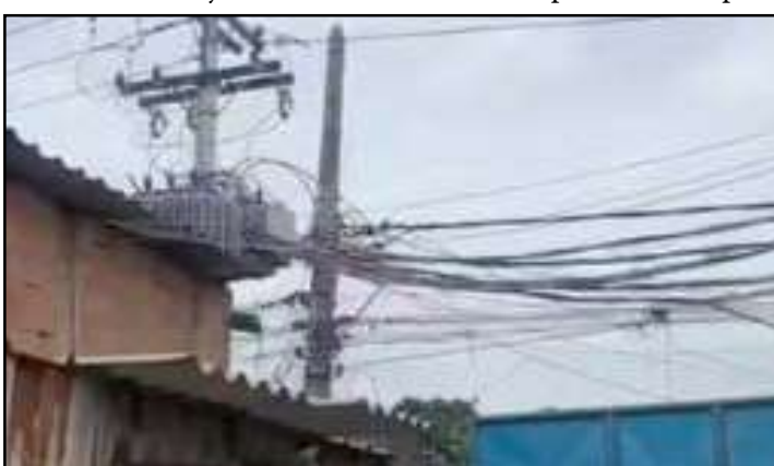
Mais de 120 equipamentos foram encontrados, funcionando por meio de furto de energia
