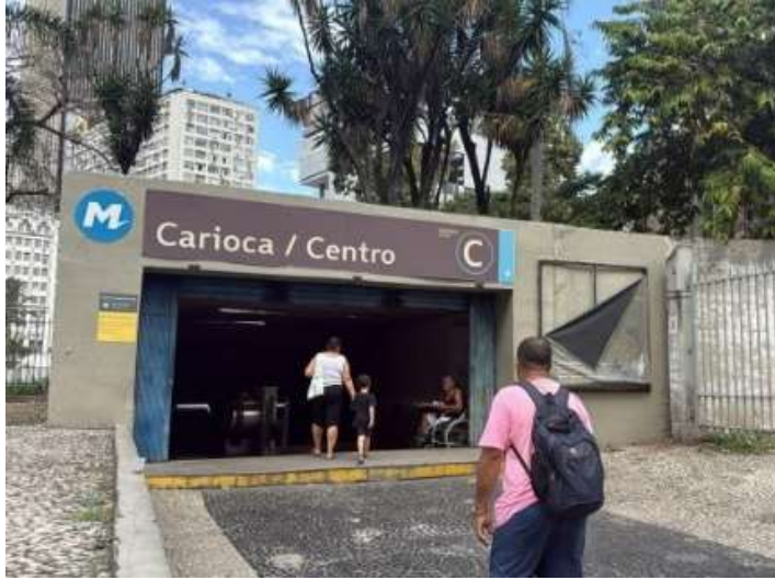
Quem circula pelo Largo da Carioca enfrenta estrutura danificada e pichações
