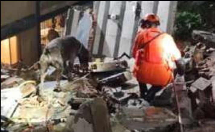
Bombeiros trabalham nos escombros do prédio que desabou em Ipanema
